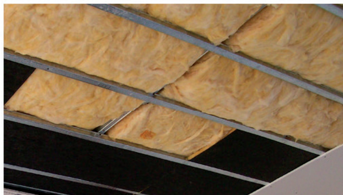
Aislamiento por el interior sobre cielorraso.
