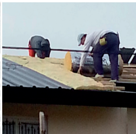
Las chapas se colocan a medida que se avanza con la colocación de la lana para evitar que quede expuesta.
